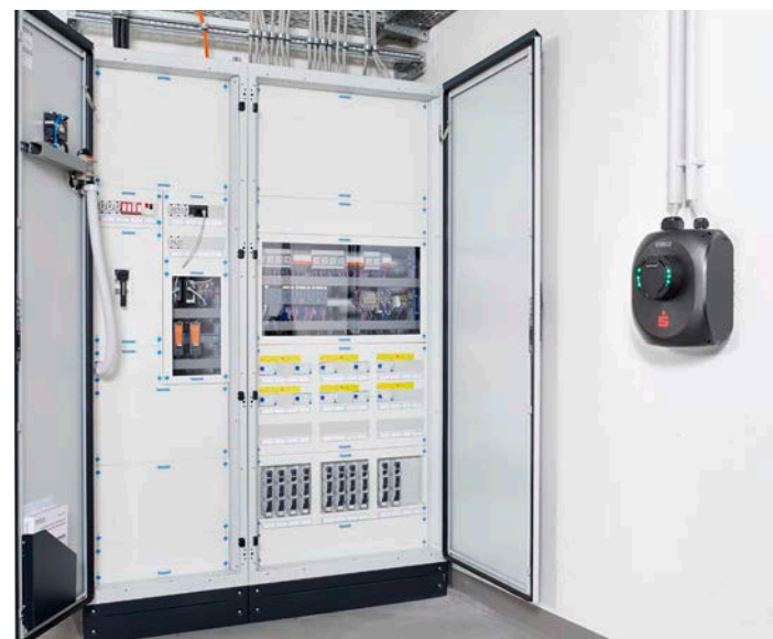
Auf Kundenwunsch wurde die Ladeverteilung als anschlussfertige SAS-Schaltanlage ausgeführt. Hensel parametrierte das Lademanagement.
