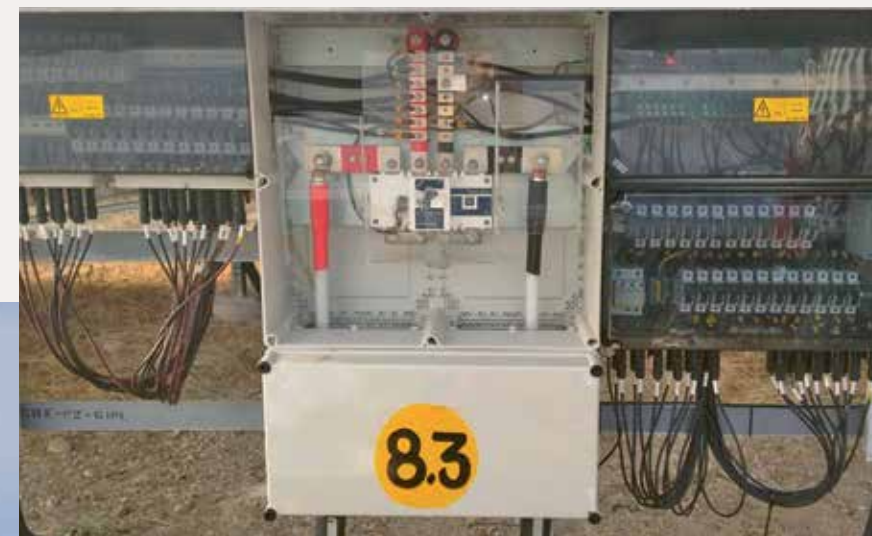
PV-Verteiler nach der Erweiterung der PV-Anlage in Chennai, Indien
