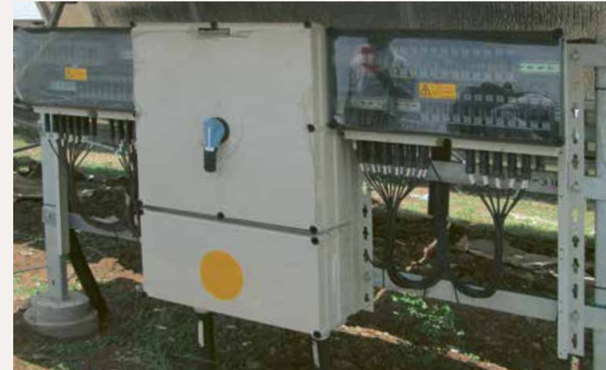
PV-Verteiler vor der Erweiterung in einer Anlage in Chennai, Indien
