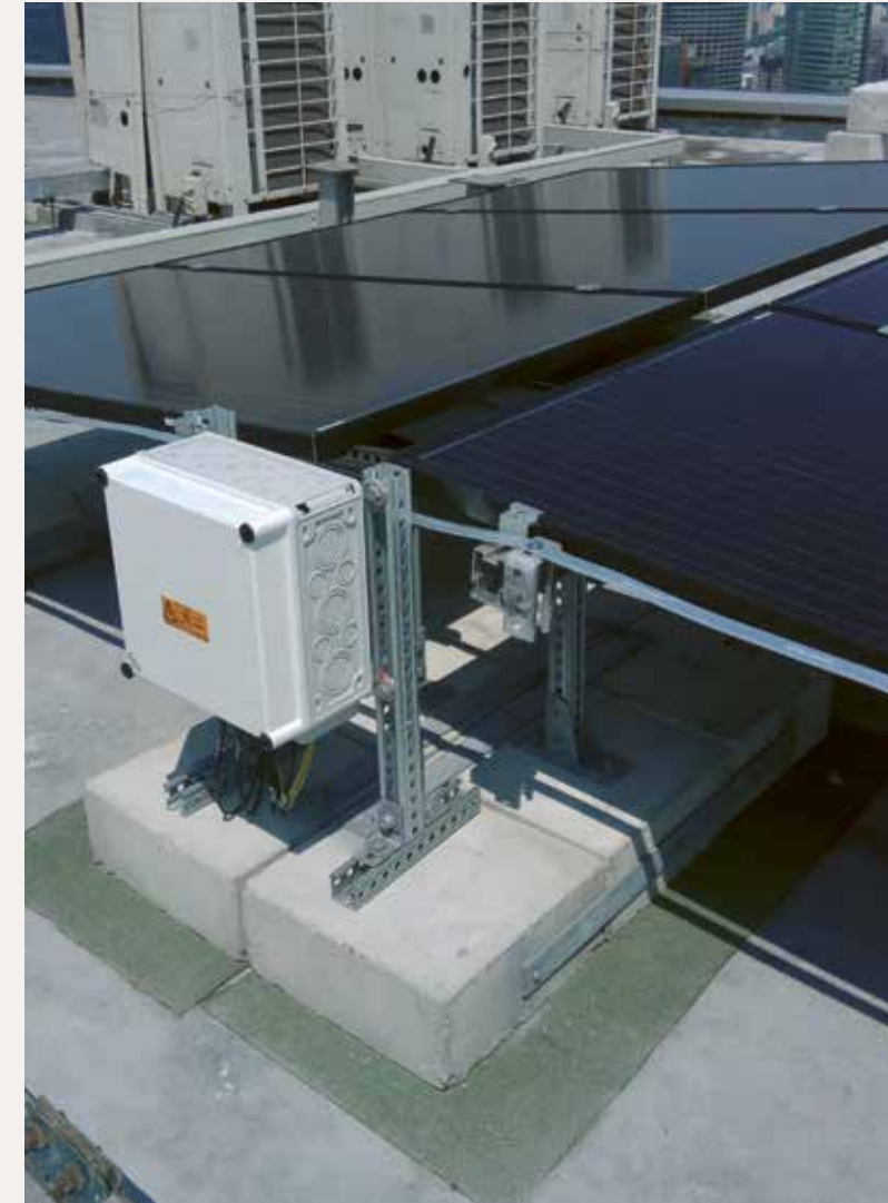
Zahlreiche PV-Generator-Anschlusskästen sind auf dem Dach des Marina Bay Sands Hotel installiert.
