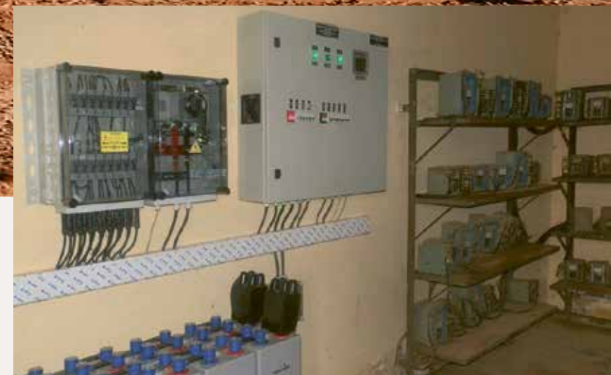
Dorf-Elektrifizierung in Liberia mit PV-Generator-Anschlusskästen, PV-Wechselrichter-Sammlern und Batterieverteilern zum Schutz der Batteriebänke
