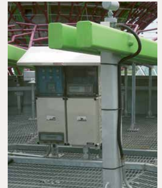
PV-Wechselrichter-Sammler sind auf den Superbäumen in Singapur installiert.
